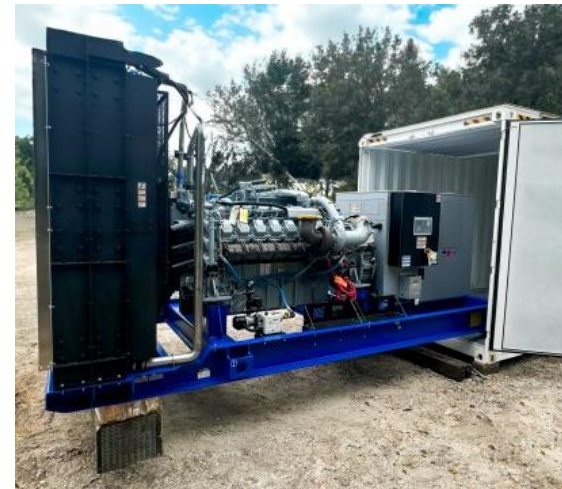
Tijdelijke gecontaineriseerde gasgenerator
