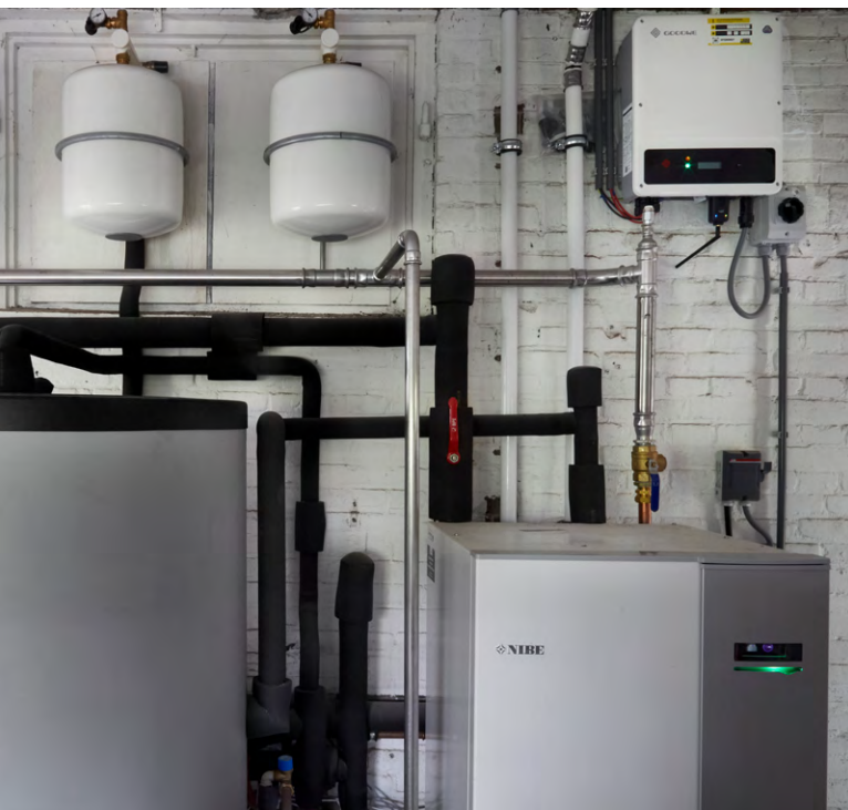
Een warmtepompsysteem in een woning, met opslagvaten en aansturing.
